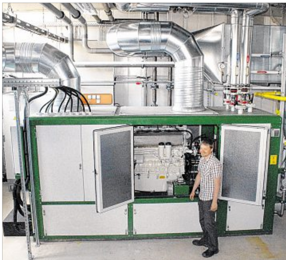
Ein deutliches Signal der Standortsicherung und der Investition in die Zukunft: Busch-Jaeger gab viel Geld für neue Techniken aus – hier für das Blockheizkraftwerk.
